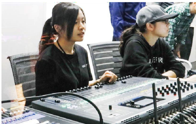
專業燈控、音控設備
