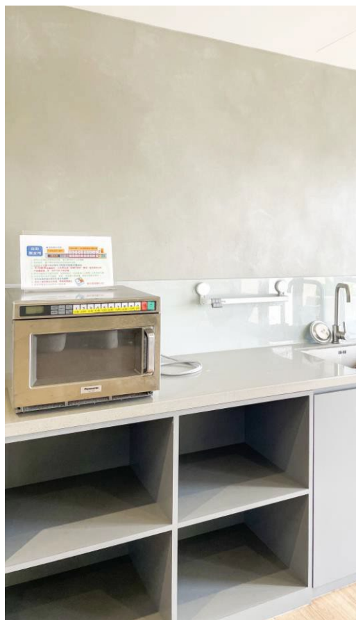
簡易廚房設備 (微波加熱設備 / 三溫飲水機)
