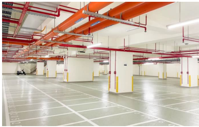
室內停車場 (為你的愛車遮風擋雨)
